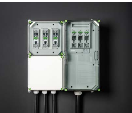
▲ GWS 7140 NH: Zum Sammeln von drei Wechselrichtern über NH000-Trenner, NH1-Trenner als Zentralabsicherung
